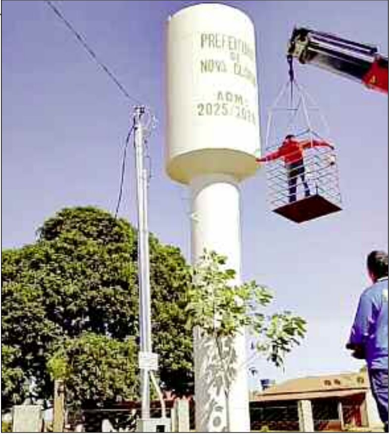
Nova caixa d'água instalada para garantir o abastecimento de água
