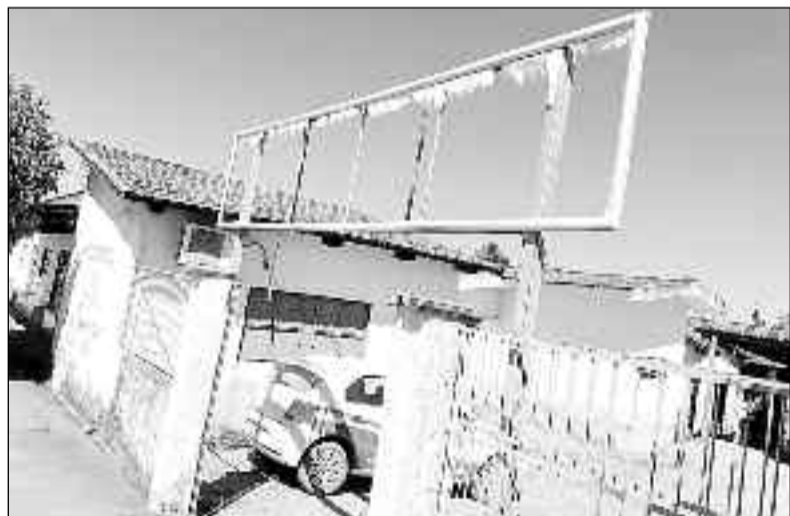
Fachada do posto de saúde totalmente desgastada por falta de gestão
