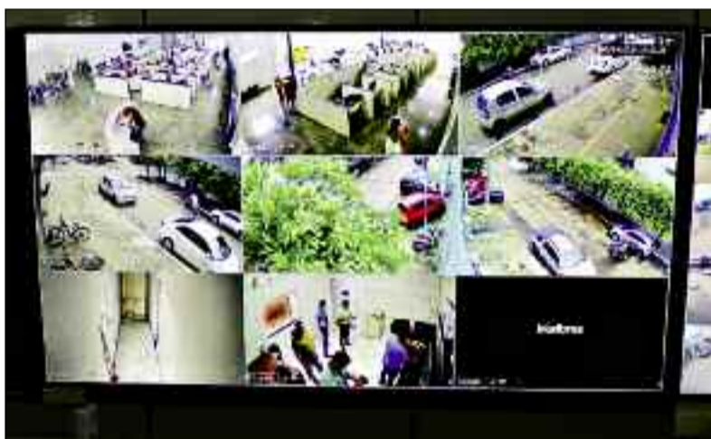
Sala de monitoramento em Alto Horizonte: mais segurança à população
